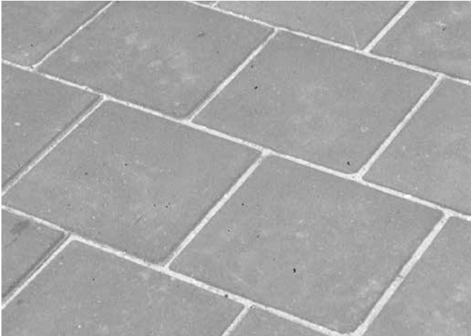
Bild 5: Ausblühungen nach einer Woche
